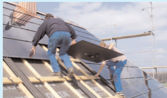
Montage einer vollintegrierten MegaSlate® Indachanlage mit monokristallinen SunPower A-300 Zellen in Cudrefin (CH), Jahresertrag 9.000 kWh.
